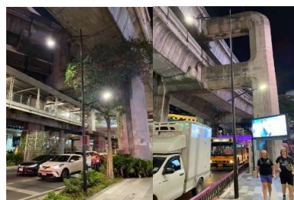
ภาพแสดงเสาไฟและโคมไฟที่ติดตั้งแล้ว
